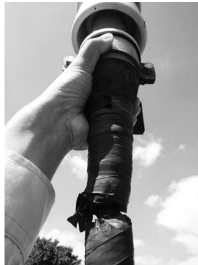
図 4-68 高圧ケーブル柱上端末部におけるシュリンクバック
