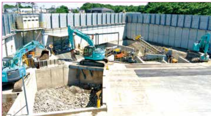
▲木村建設オリジナル「環境型地下プラント」
