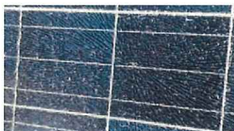
↑太陽光パネル表面の破損
