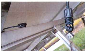
↑太陽光パネルコネクタの接続部分の焼損
