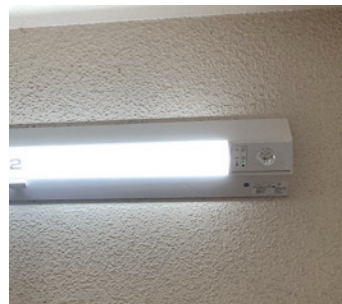
非常用照明付 階段灯
