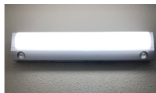
非常用照明付 階段通路誘導灯
