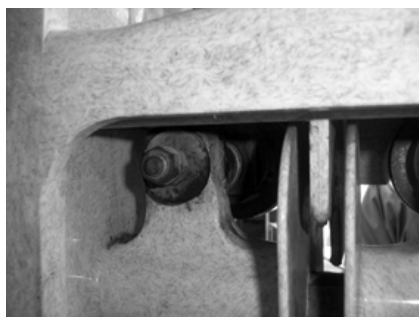
● VCB 表面放電痕
